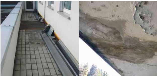
Недостаточная гидроизоляция балкона приводит к массивным повреждениям.
